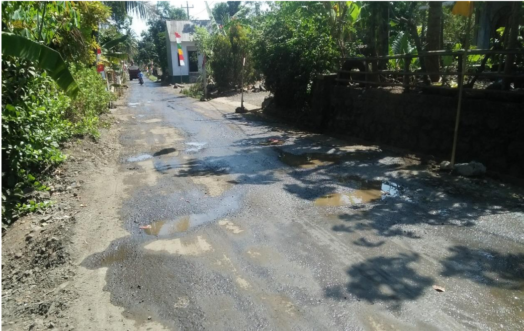
Kerusakan Jalan Desa
