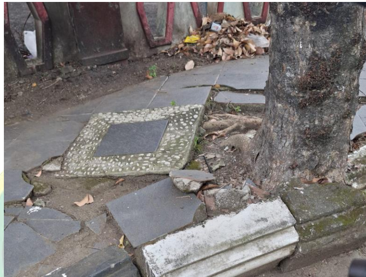
Gambar 7 Kondisi Trotoar Rusak (Lokasi beberapa titik di Jalan Kalimantan– Tanggal: 9 Juni 2025 Sumber: Dokumentasi pribadi peneliti)
