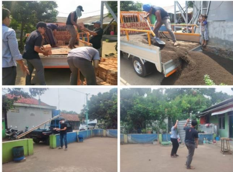
Gambar 2. Penurunan Material Bangunan
