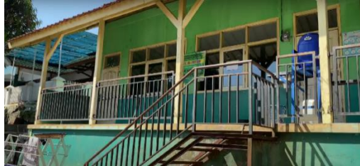
Gambar 4. Kondisi Gedung Belajar MDT Al-Fathu
