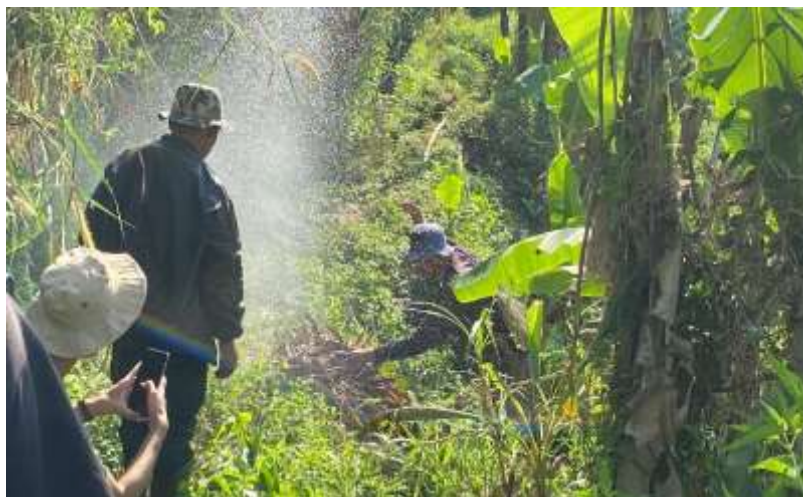
Gambar 5. Salah satu titik pipa yang rusak
