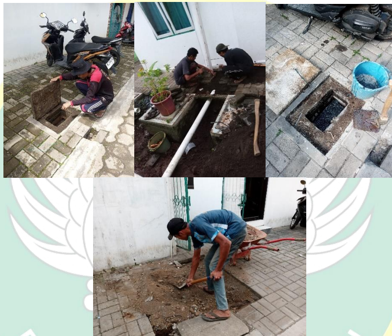
Gambar 2.17 perawatan bak kontrol aliran air pesantren
