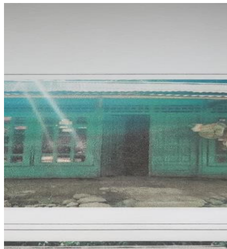
Gambar 9 Foto rumah sebelum direhab
