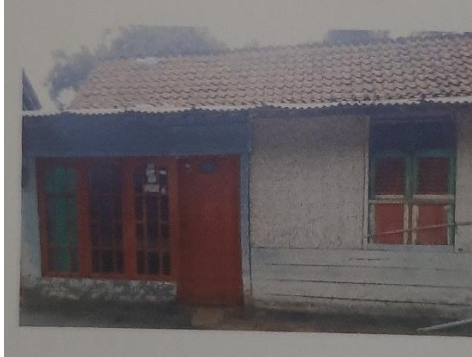
Gambar 13 Foto rumah sebelum direhab
